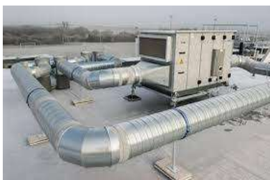
Centrale de Traitement d'Air
