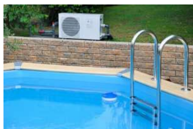
Pompe à Chaleur
